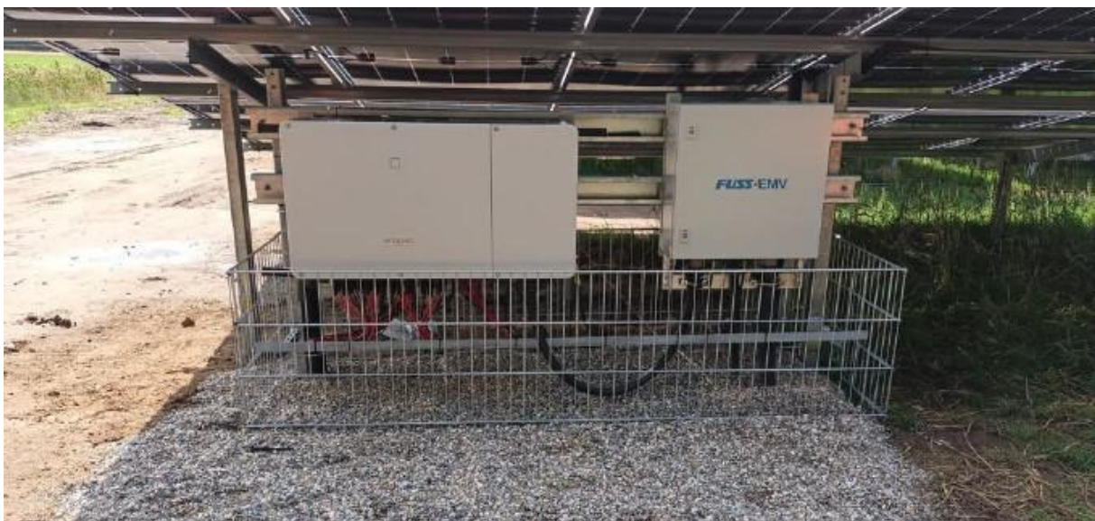
Figuur 8: Voorbeeld opstelling omvormers achter zonnepanelen.
