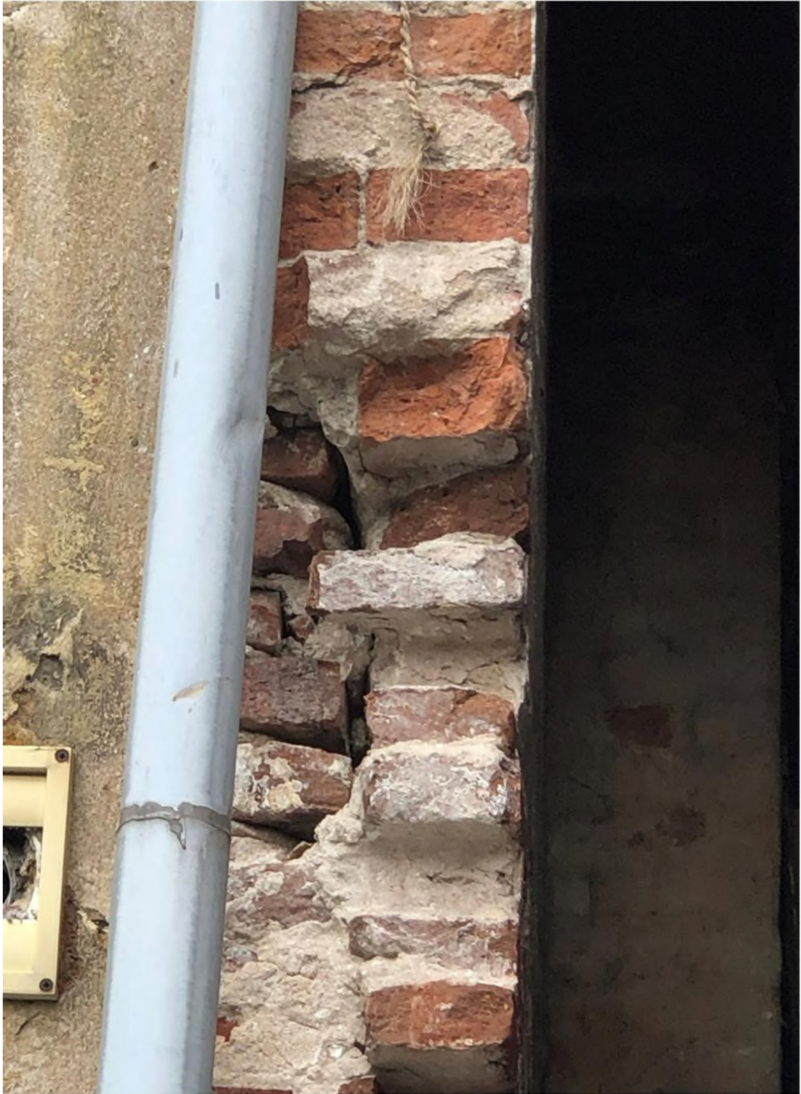
Foto slechte staat metselwerk Oudegracht 228
