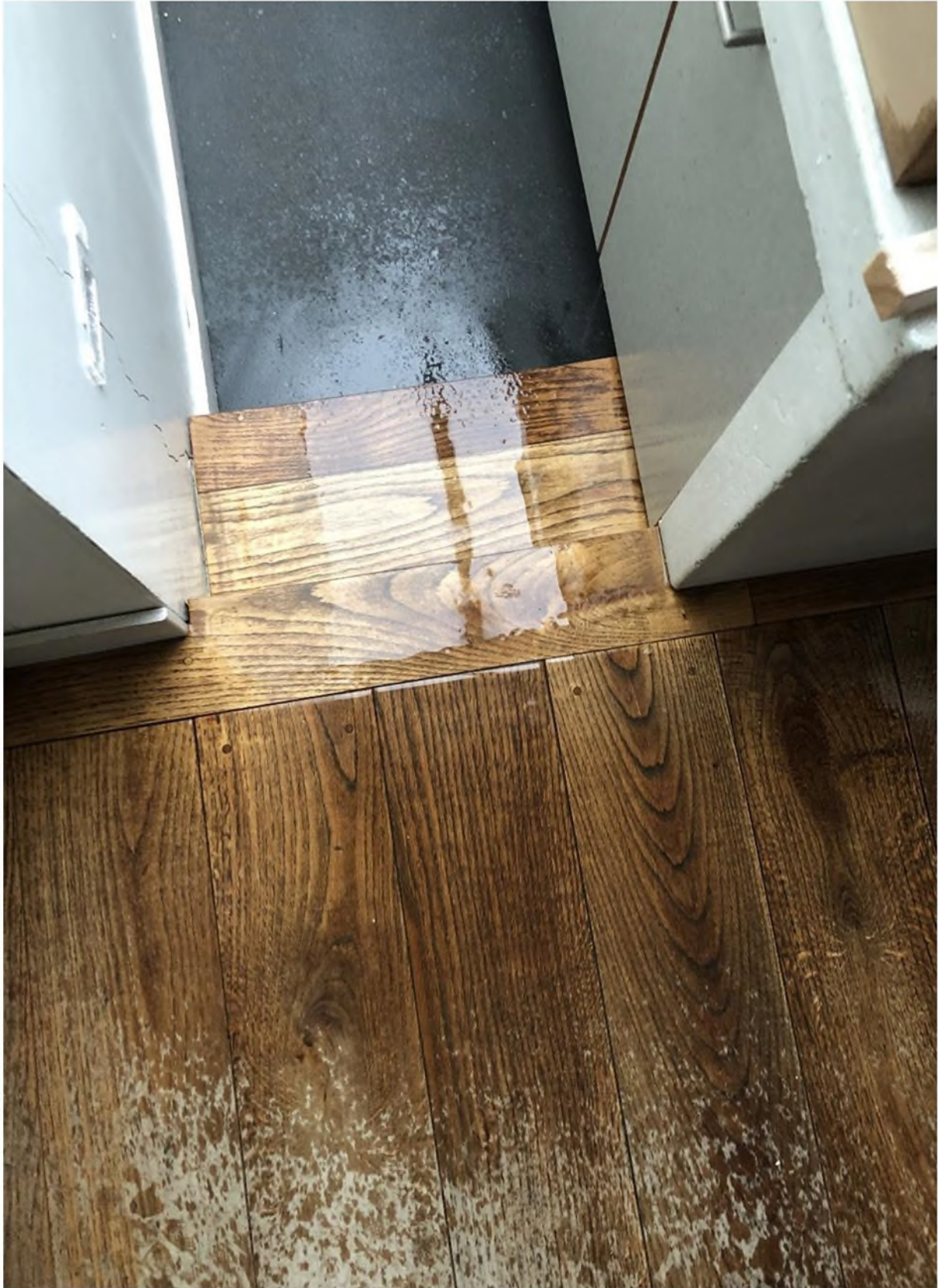
Foto waterschade Oudegracht 230
