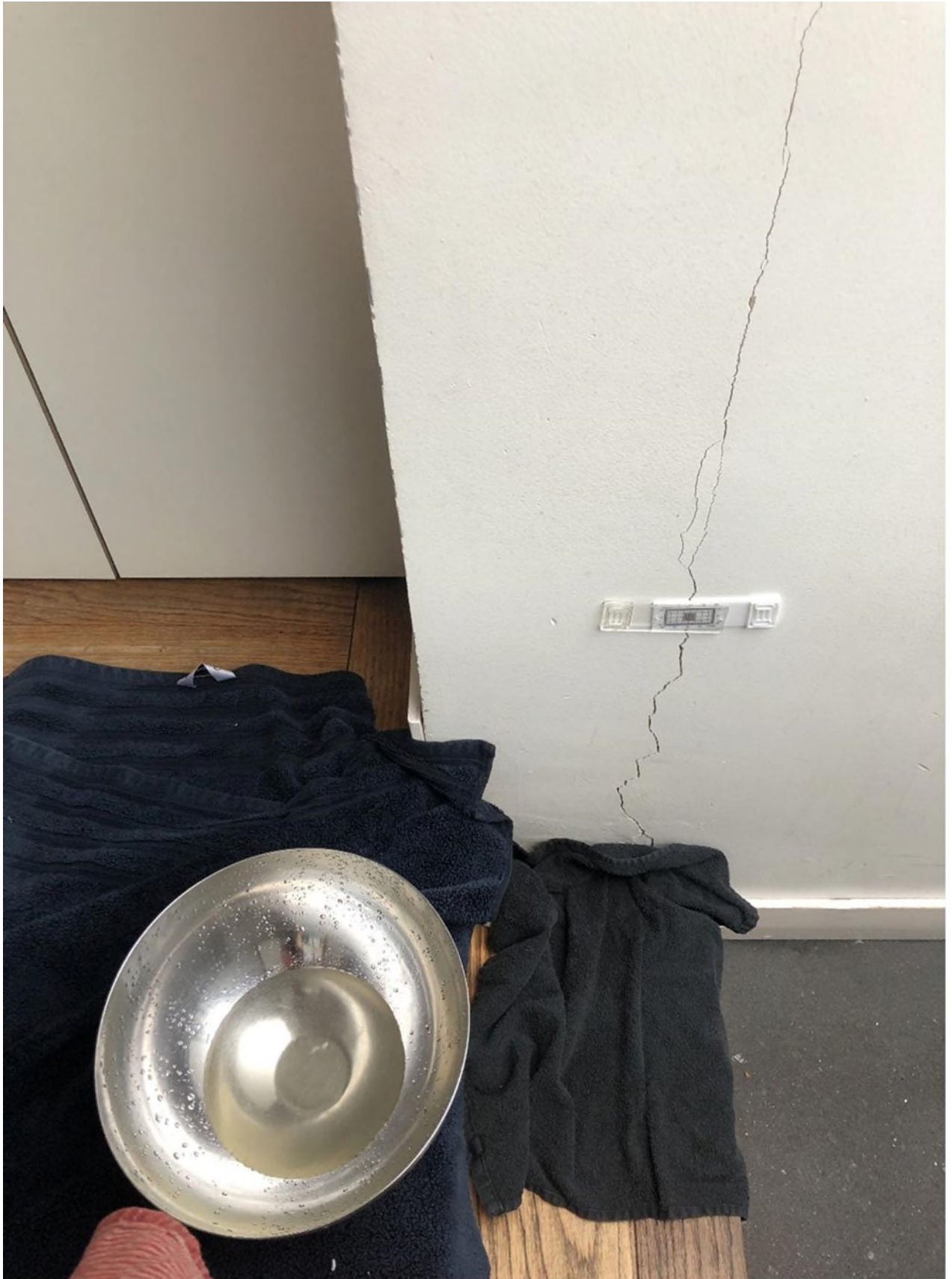
Foto waterschade Oudegracht 230
